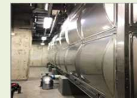
耐震性貯水槽
