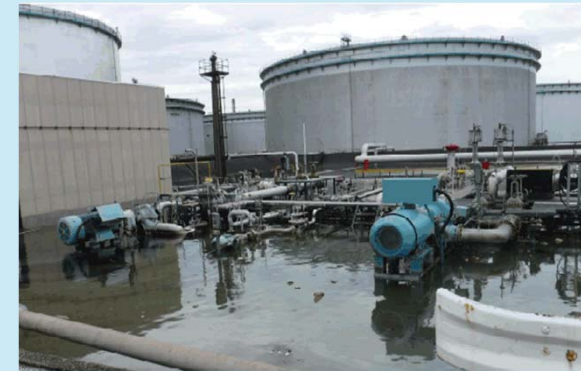
（製油所で発生した冠水被害）
