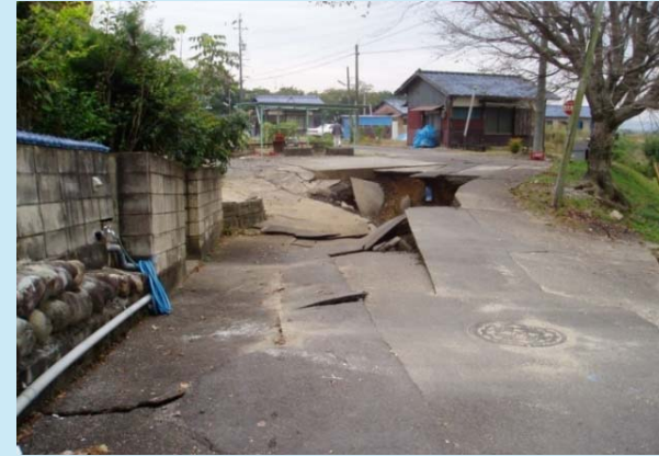
大規模陥没事故 (岐阜県御嵩町)
